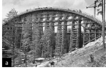
Ryc. 14. Postęp w budowaniu betonowych łuków mostowych: a) most autostradowy, Jena, Niemcy, 1937, pełne rusztowanie pod krzywizną łuku, b) most Maslenica, Chorwacja, L_{max} = 200 m, 1997, nawisowe betonowanie łuku
