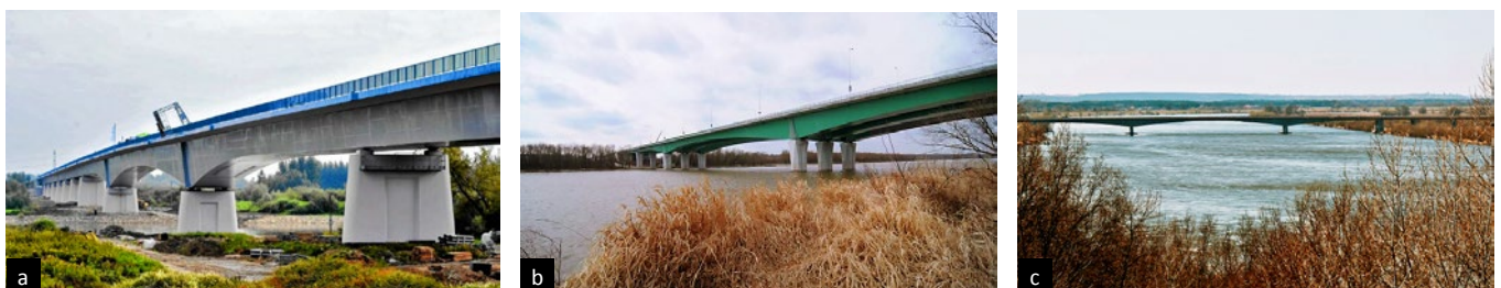
Ryc. 4. Rekordowe mosty belkowe w Polsce: a) stalowy (zespolony) przez Wisłę w Potańcu, L_{\max} = 160 m, 2014, b) im. Marii Skłodowskiej-Curie przez Wisłę w Warszawie, stalowy (zespolony), L_{\max} = 160 m, 2012, c) z betonu sprężonego przez Wisłę w Grudziądzu, L_{\max} = 180 m, 2013
