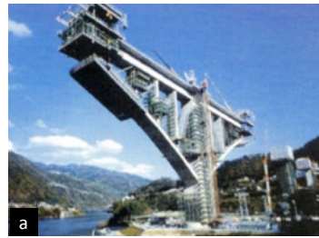
Ryc. 15. Most Ikeda – Hesokko, Japonia, L_{max} = 200 m, 2000: a) jednoczesne betonowanie nawisowe łuku oraz pomostu, b) ukończony most
