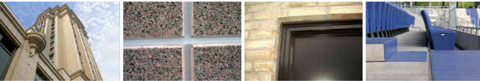
Szczeliny w elewacji Szczeliny między elementami prefabrykowanymi Szczeliny między różnymi elementami elewacji Szczeliny dylatacyjne w podłodze elewacji
